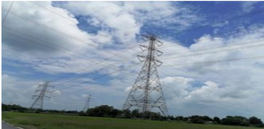
รูปภาพที่ 10 เสาไฟฟ้าแรงสูง
